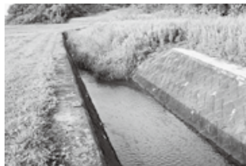
堆積土砂に葦が生い茂った奥田地区荒屋敷川
