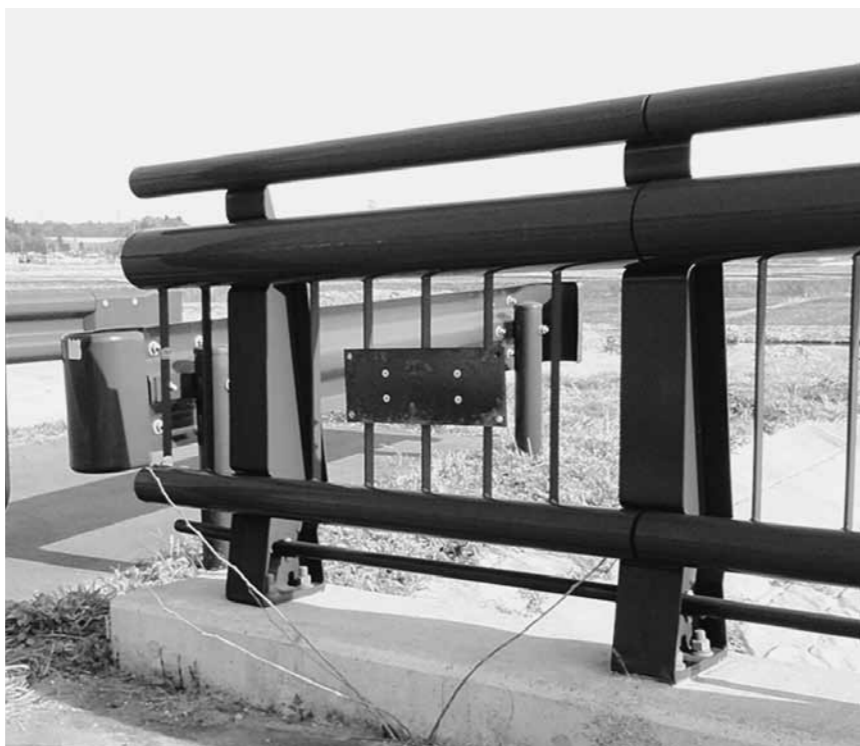
橋名板の盗難被害にあった雁又橋
