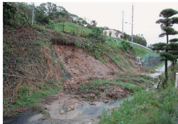
▲村道奥田大森線沿い法面の土砂崩れ
