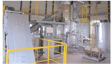
▲木質バイオマスボイラー設備
