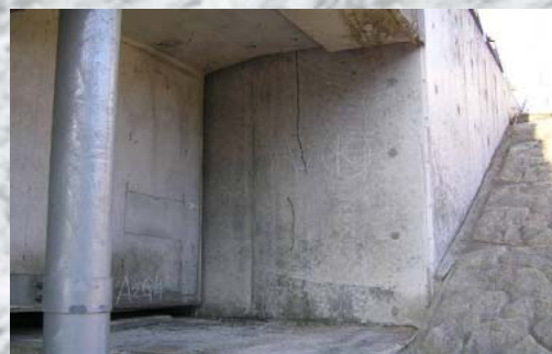
下部工の ひび割れ
