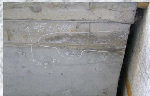
上部工の 遊離石灰
