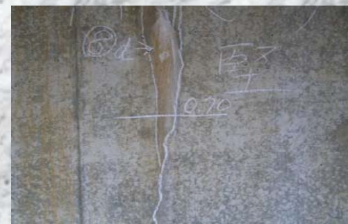
下部工の ひび割れ
