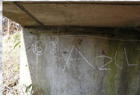
下部工の ひび割れ
